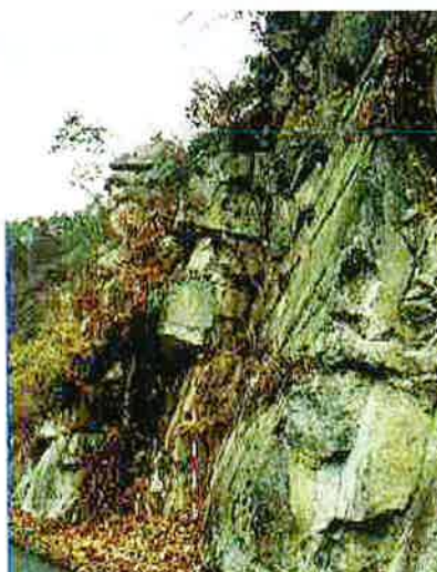
節理が発達した硬質な花崗岩。1m程度の 岩塊が節理沿いに抜け落ちている。
