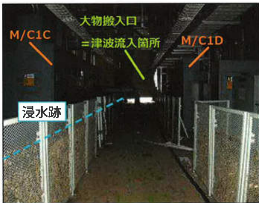
写真2. 2. 3-12 津波後の1号機タービン建屋1階の状況 33
