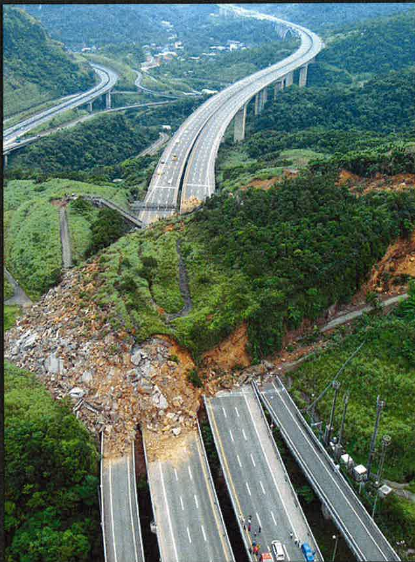
切り土のところが崩壊
