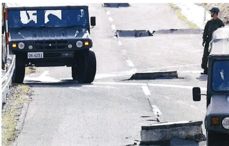
(甲全第804号証・石川県珠洲市・地震によって突き出たマンホール)
