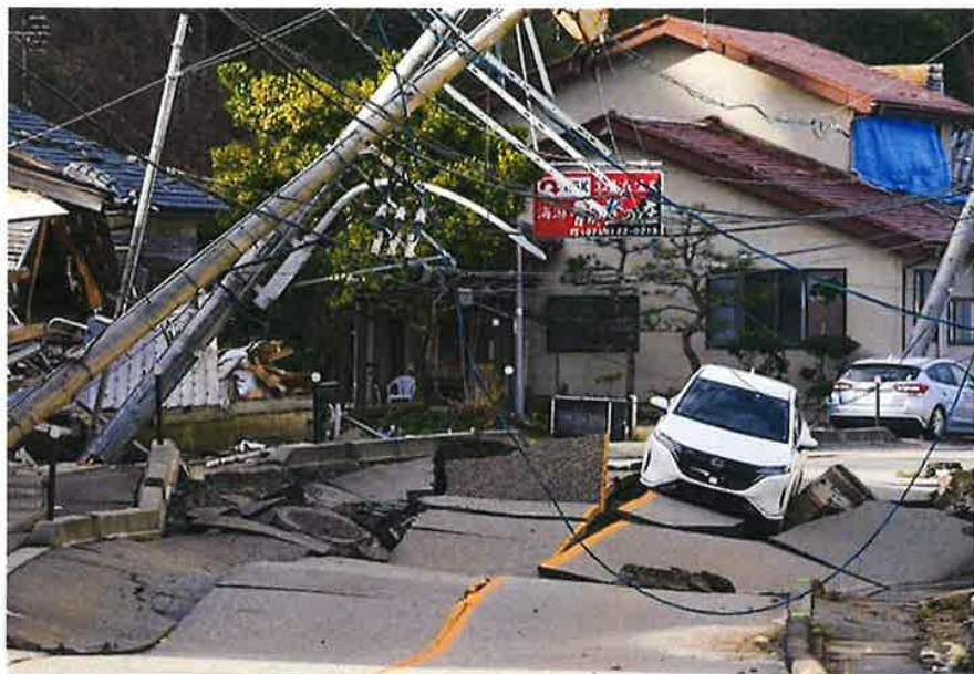
（甲全第804号証・輪島市・国道247号線）
