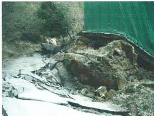
斜面崩壊の東部にある工場付近の道路で数本の亀裂が見られる。亀裂の一部は近くに存在する湯ノ岳断層と同方向であり、湯ノ岳断層の活動との関連性が示唆される。県道 14 号線沿いの西側にも斜面崩壊や道路の亀裂が確認される。
