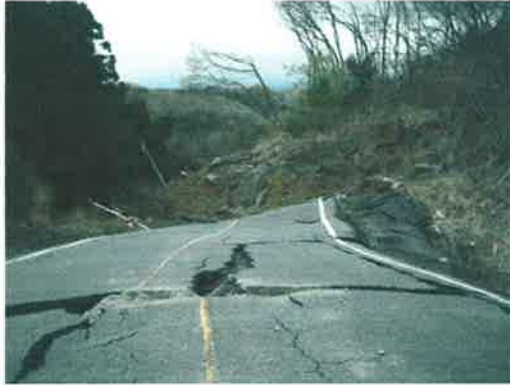
東方から撮影。県道 14 号線が、北方の山体の崩落に伴う押し出しにより大きく破壊されていることが分かる。
