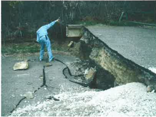
県道 14 号線に西側（写真の左側）約 110cm 低下の断層変位が生じている。写真は南側から撮影。
