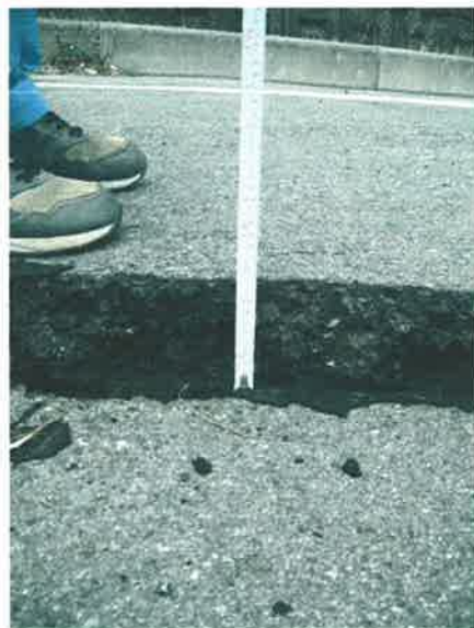
開口幅は5cm、段差は10cm。
