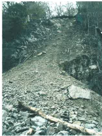
断層変位の直ぐ西側の急峻な切土斜面で、斜面崩壊がある。岩塊がブロック状に崩落している。地質は緑色岩起源の片岩（御斎所変成岩類）。写真は南側から撮影。
