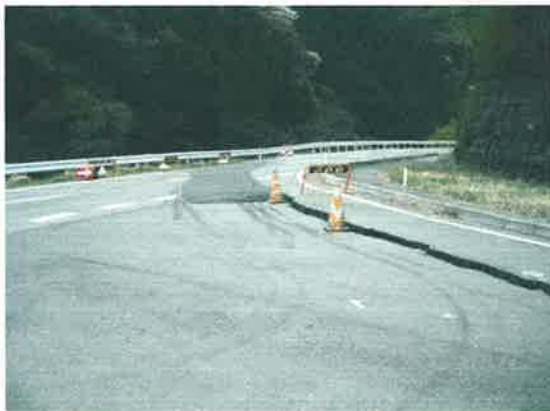
ほぼ南北方向に亀裂が入っている。北東側から撮影。東側が落ちている。
