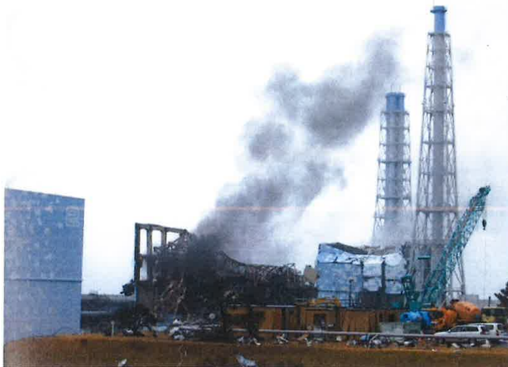
2011年3月14日に3号機の原子炉建屋が水素爆発を起し、大破した。21日には煙が発生し、作業員が一時避難した。右奥は4号機=2011年3月21日、東京電力撮影
