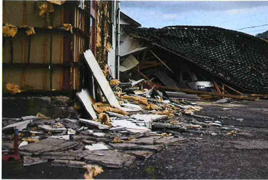
(甲全第804号証・1月5日石川県穴水町)
